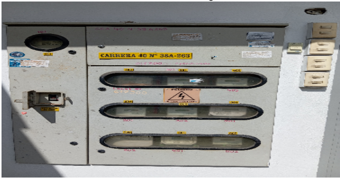
Contador de Energia
