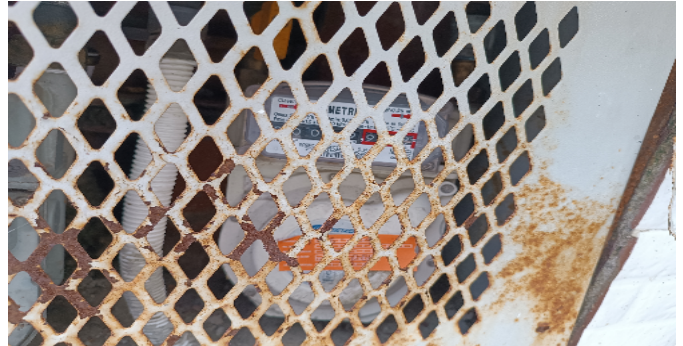
Contador de Gas
