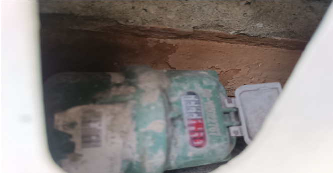
Contador de Agua
