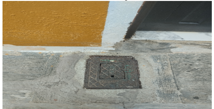
Contador de Agua
