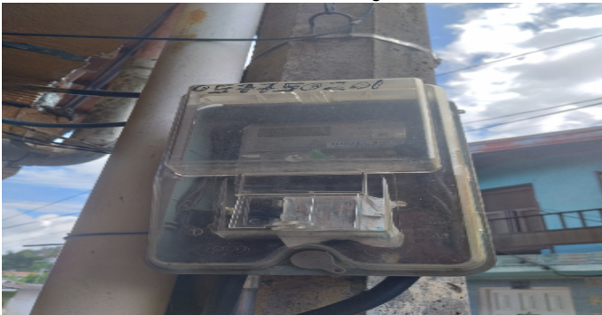
Contador de Energia
