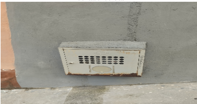
Contador de Gas
