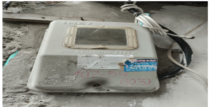
Contador de Energia
