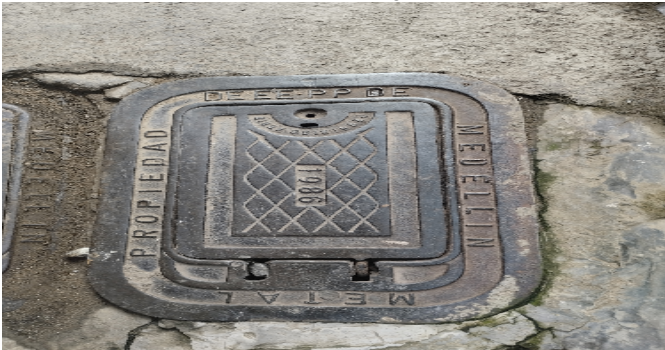
Contador de Agua
