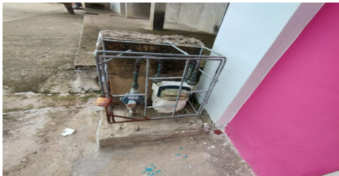
Contador de Gas
