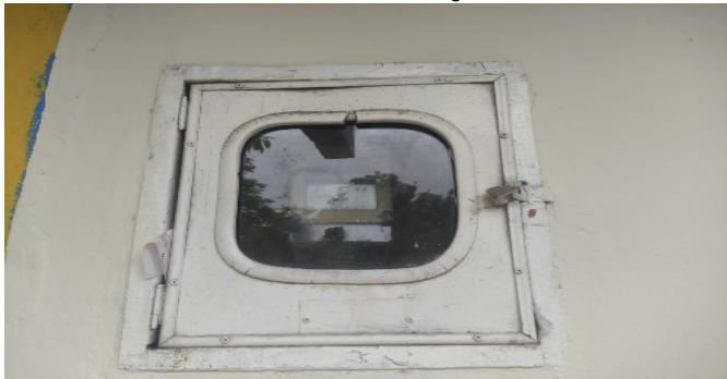
Contador de Energia
