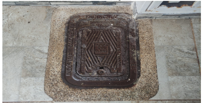
Contador de Agua
