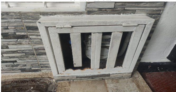
Contador de Gas
