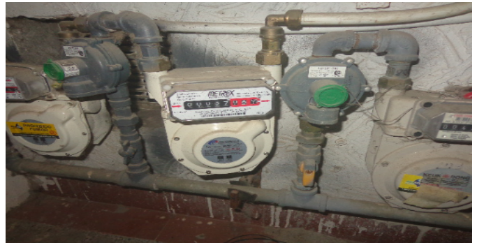
Contador de Gas
