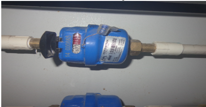
Contador de Agua
