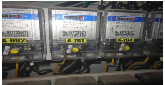
Contador de Energia
