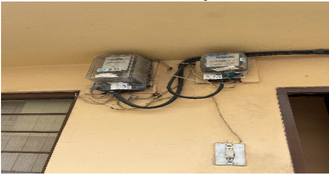
Contador de Energia
