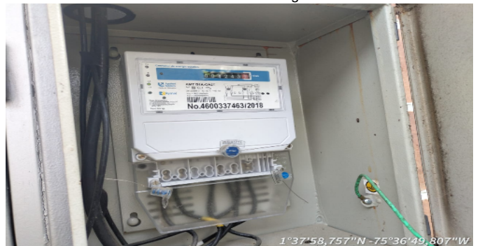
Contador de Energia
