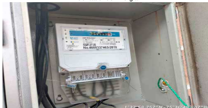
Contador de Energia
