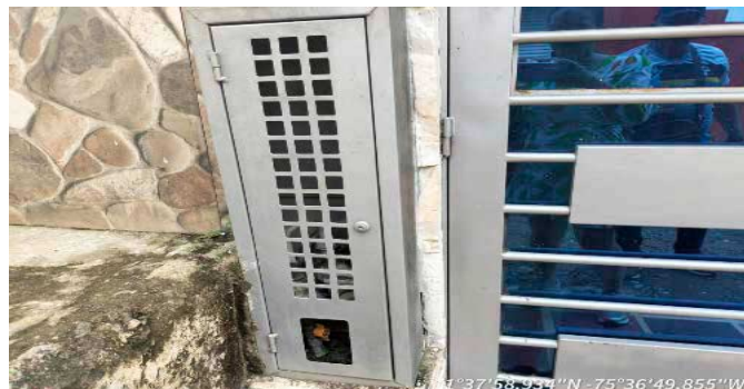
Contador de Gas
