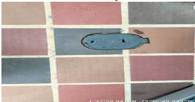
Contador de Agua
