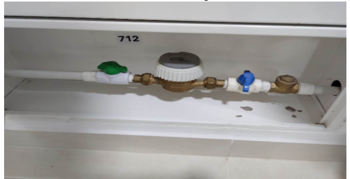
Contador de Agua
