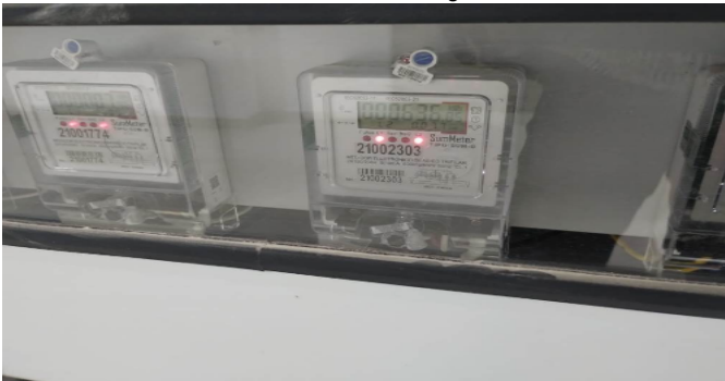
Contador de Energia
