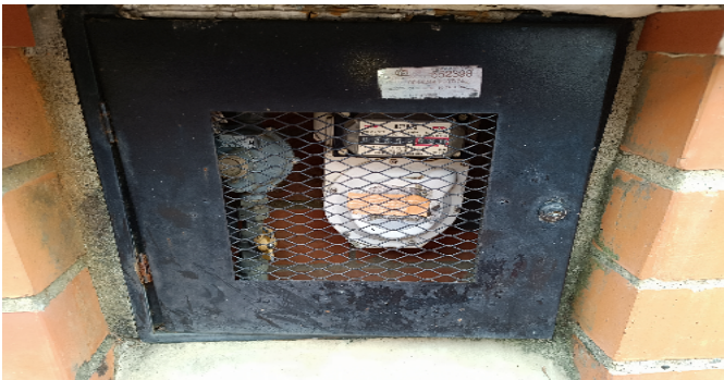
Contador de Gas
