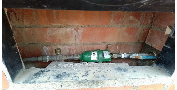
Contador de Agua
