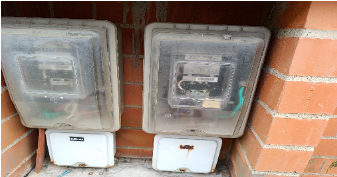
Contador de Energia
