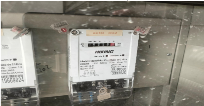
Contador de Energia
