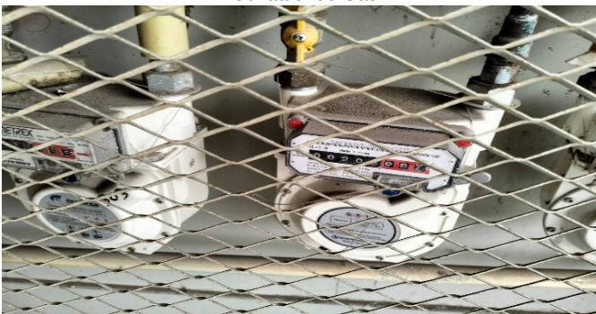
Contador de Gas
