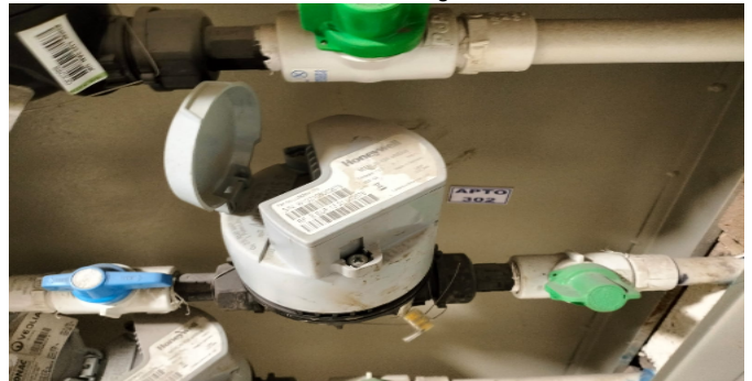
Contador de Agua
