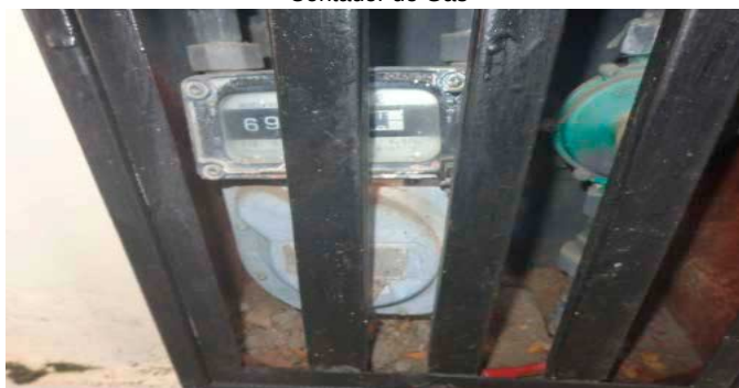
Contador de Gas
