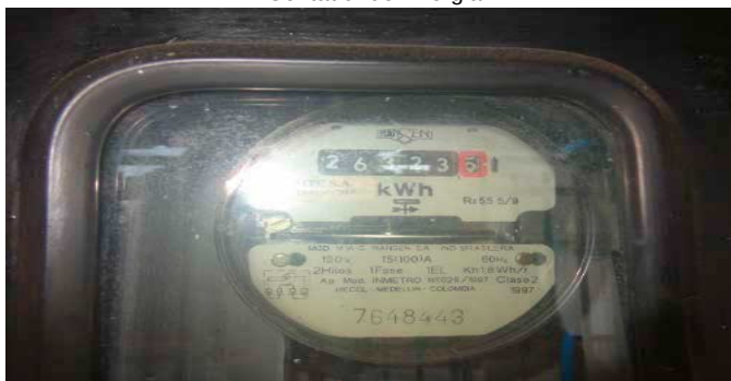
Contador de Energia
