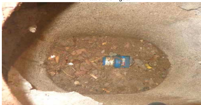
Contador de Agua
