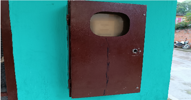
Contador de Energia
