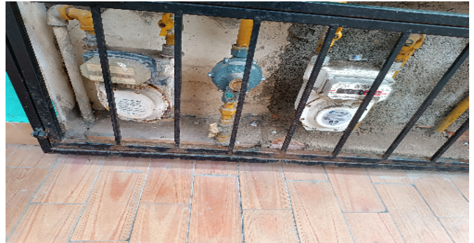
Contador de Gas
