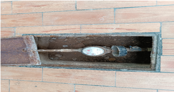
Contador de Agua
