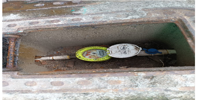
Contador de Agua
