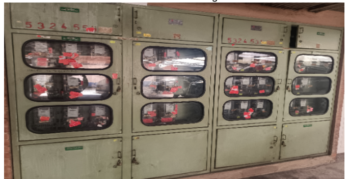
Contador de Energia
