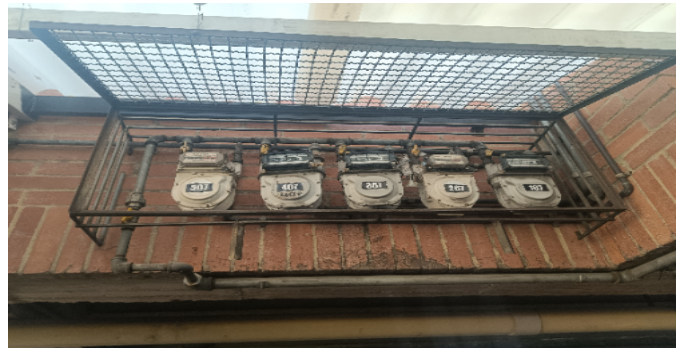
Contador de Gas
