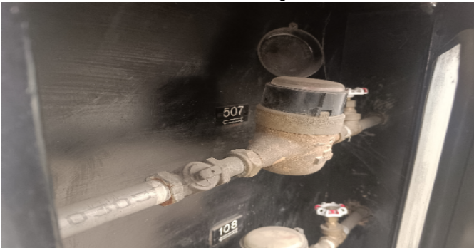
Contador de Agua
