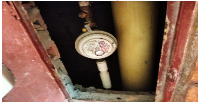
Contador de Agua
