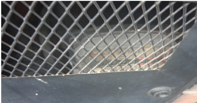
Contador de Gas
