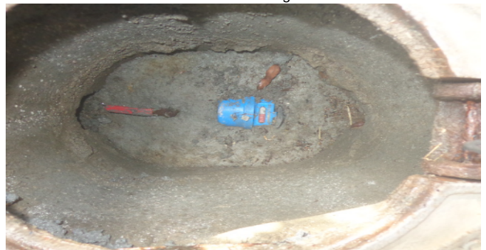
Contador de Agua
