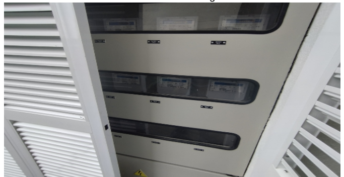
Contador de Energia
