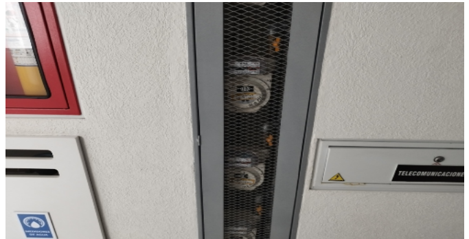
Contador de Gas
