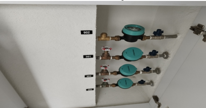
Contador de Agua
