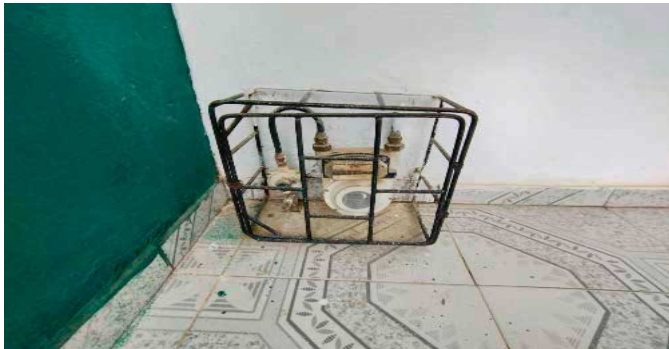
Contador de Gas
