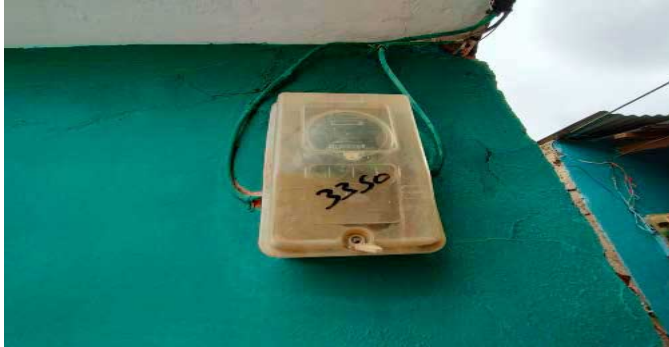
Contador de Energia
