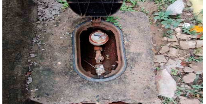
Contador de Agua
