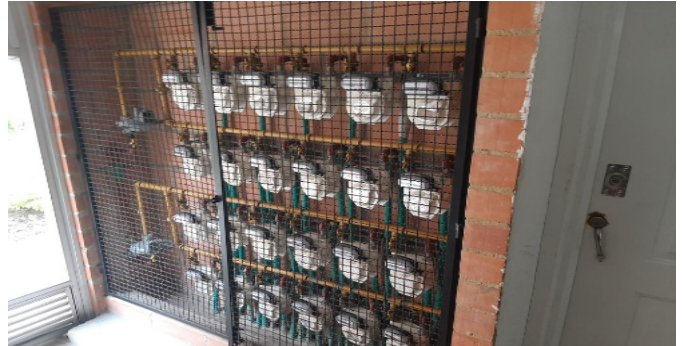
Contador de Gas
