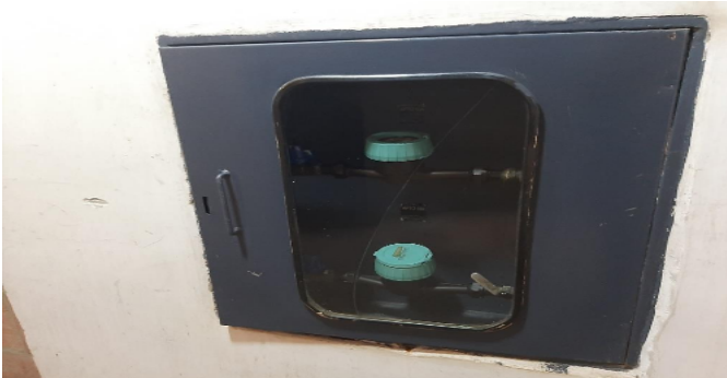
Contador de Agua
