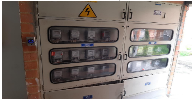
Contador de Energia
