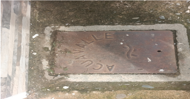
Contador de Agua
