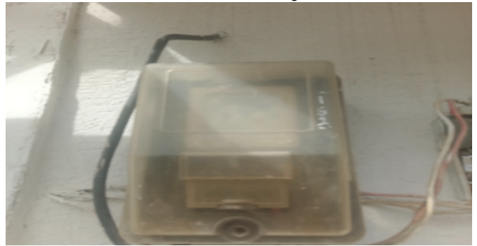
Contador de Energia
