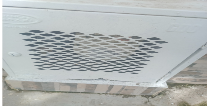
Contador de Gas
