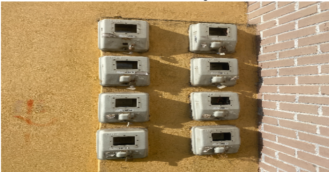
Contador de Energia
