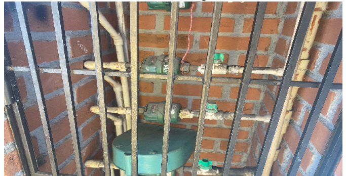
Contador de Agua
