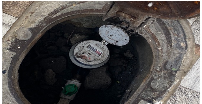
Contador de Agua
