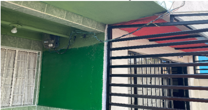
Contador de Energia
