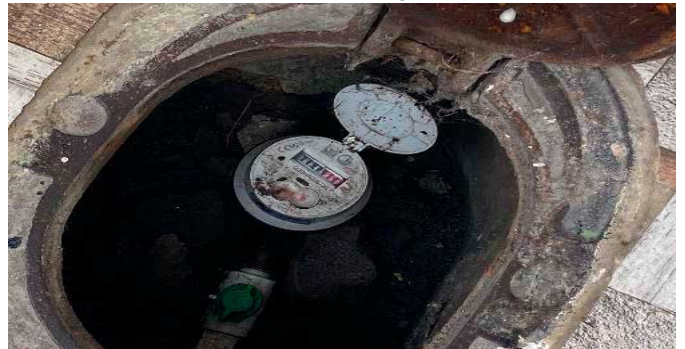
Contador de Agua
