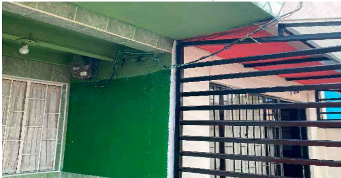
Contador de Energia
