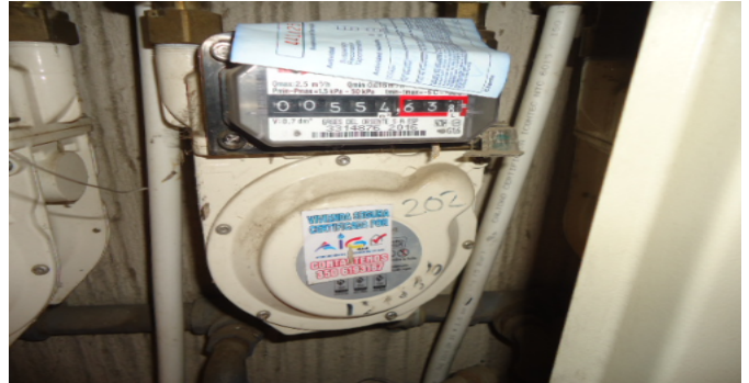
Contador de Gas
