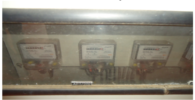
Contador de Energia
