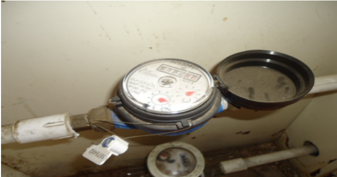
Contador de Agua
