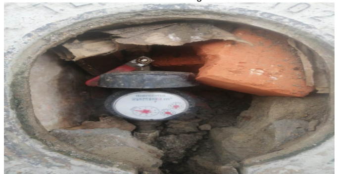
Contador de Agua
