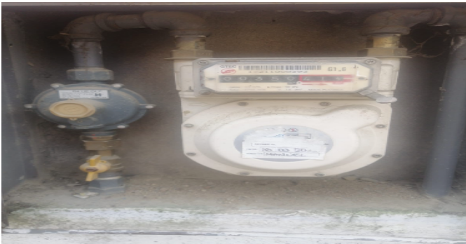
Contador de Gas
