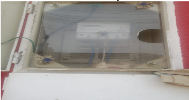
Contador de Energia
