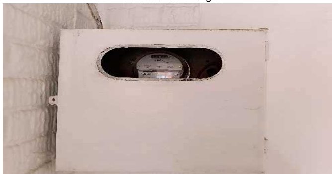
Contador de Energia
