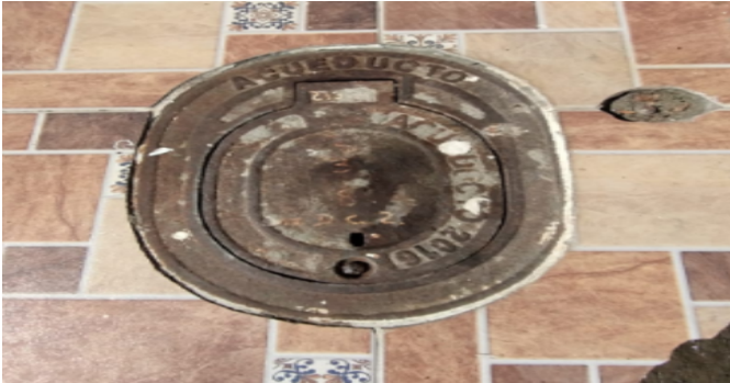
Contador de Agua
