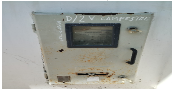
Contador de Energia
