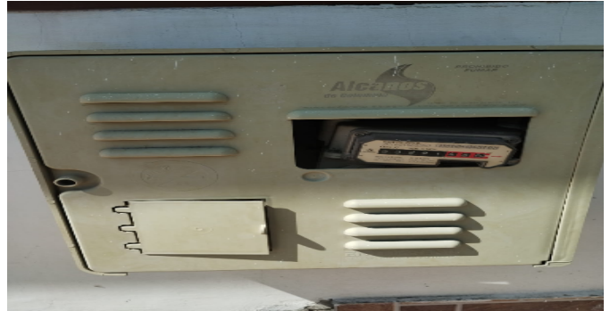
Contador de Gas
