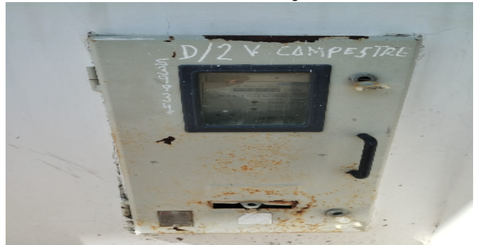
Contador de Energia
