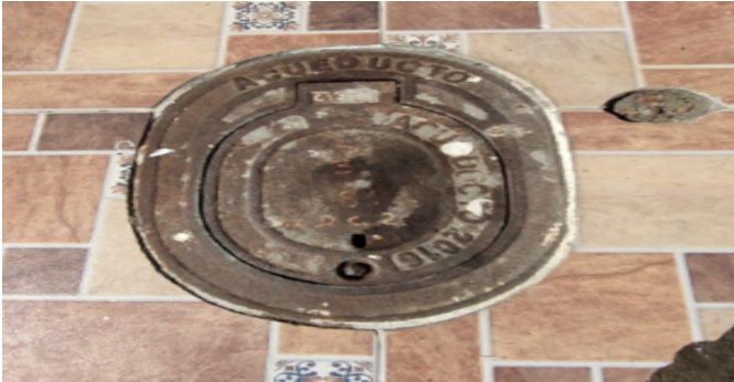
Contador de Agua
