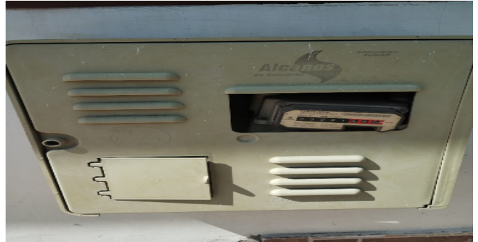
Contador de Gas
