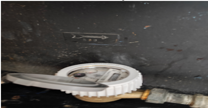
Contador de Agua
