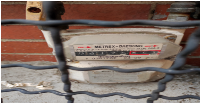
Contador de Gas
