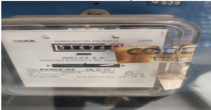
Contador de Energia
