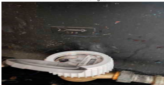
Contador de Agua
