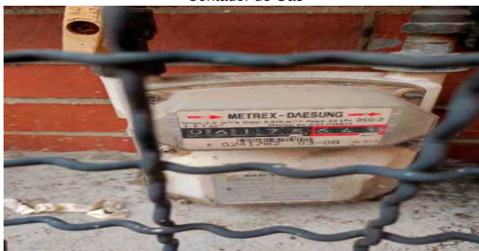
Contador de Gas
