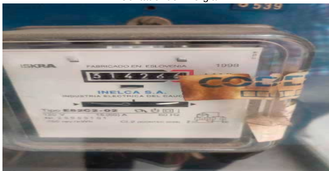
Contador de Energia
