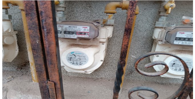
Contador de Gas
