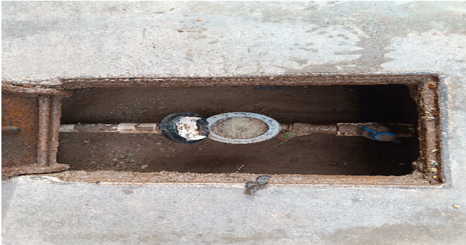
Contador de Agua
