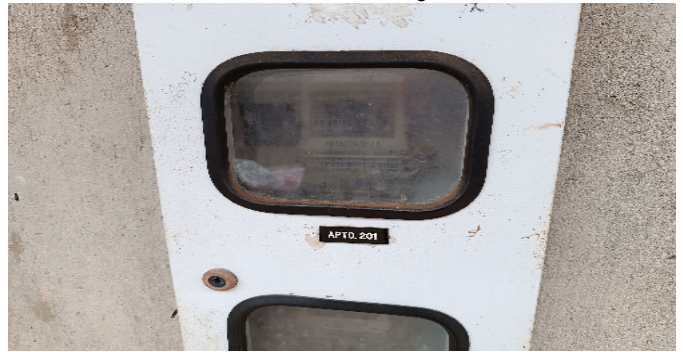
Contador de Energia
