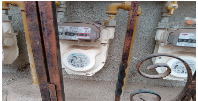
Contador de Gas
