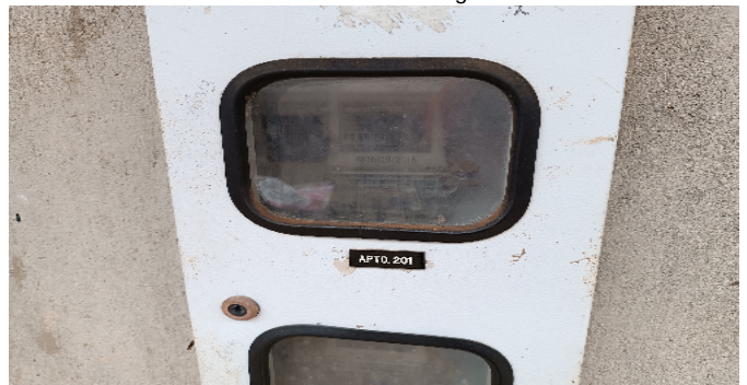
Contador de Energia
