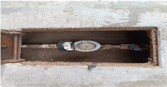
Contador de Agua
