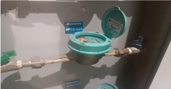
Contador de Agua
