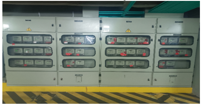
Contador de Energia
