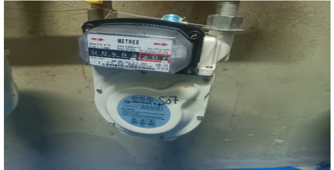
Contador de Gas
