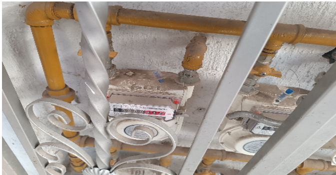
Contador de Gas
