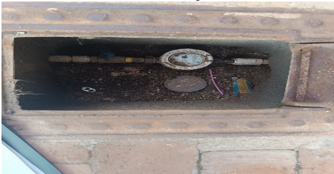
Contador de Agua
