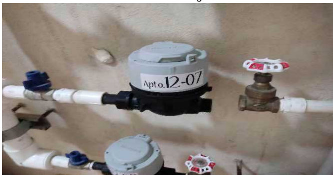
Contador de Agua
