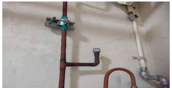
Contador de Gas
