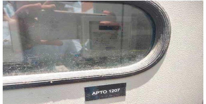
Contador de Energia
