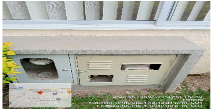
Contador de Gas
