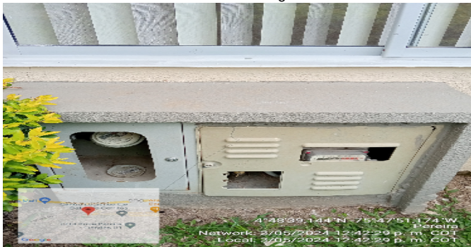
Contador de Agua
