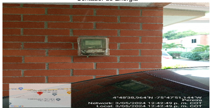
Contador de Energia
