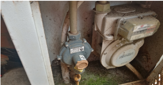
Contador de Gas
