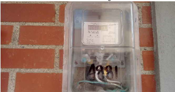
Contador de Energia
