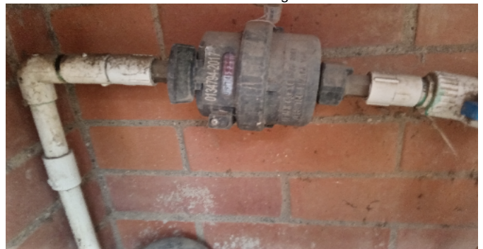
Contador de Agua
