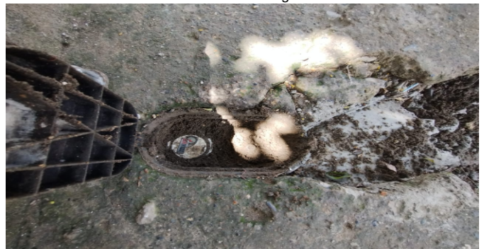
Contador de Agua
