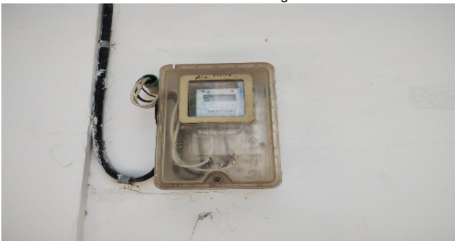
Contador de Energia
