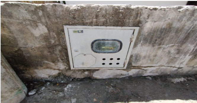
Contador de Gas
