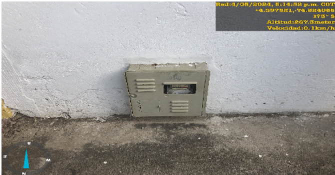
Contador de Gas
