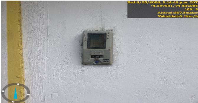
Contador de Energia
