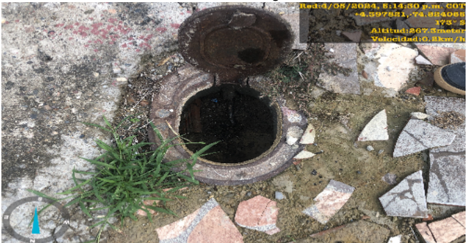
Contador de Agua
