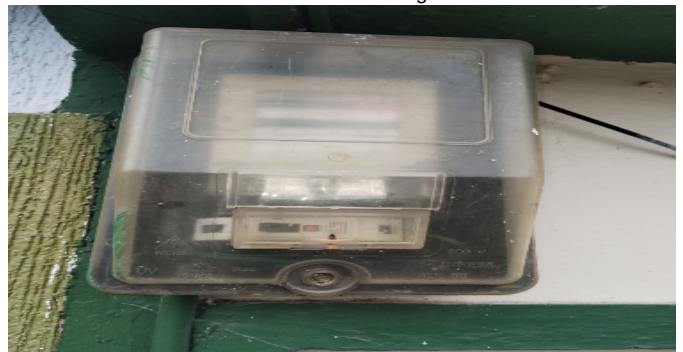
Contador de Energia
