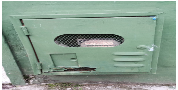
Contador de Gas
