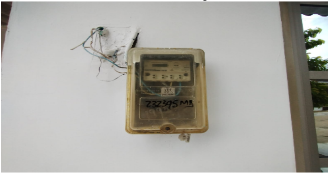
Contador de Energia
