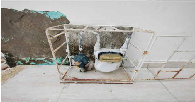
Contador de Gas
