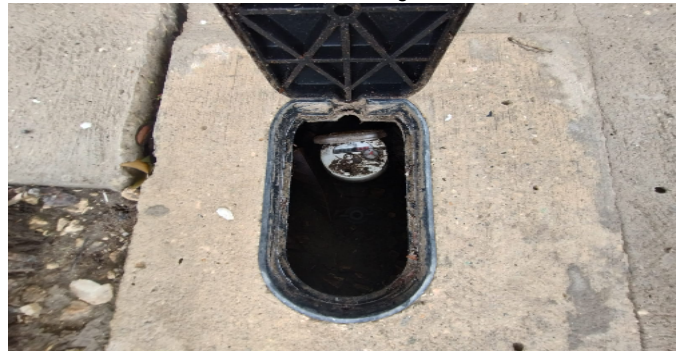
Contador de Agua
