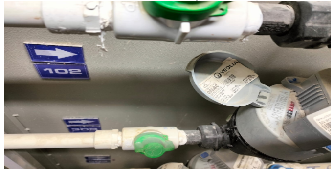
Contador de Agua
