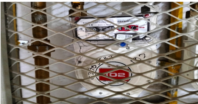
Contador de Gas
