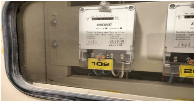
Contador de Energia
