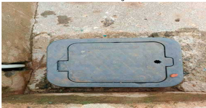
Contador de Agua
