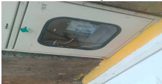
Contador de Energia
