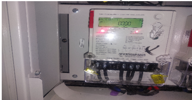
Contador de Energia
