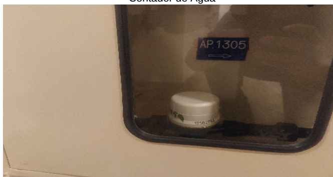
Contador de Agua
