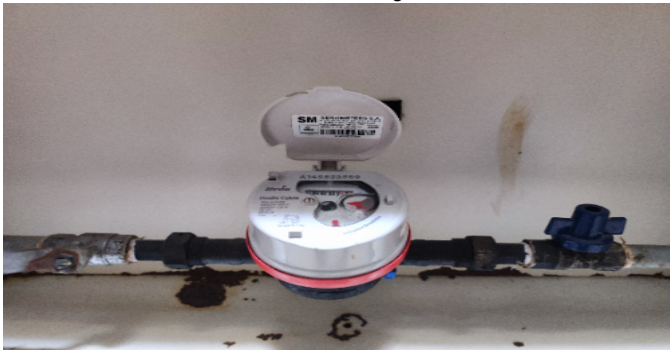
Contador de Agua
