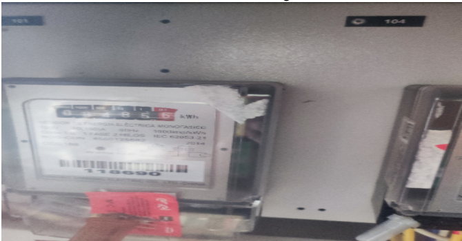
Contador de Energia
