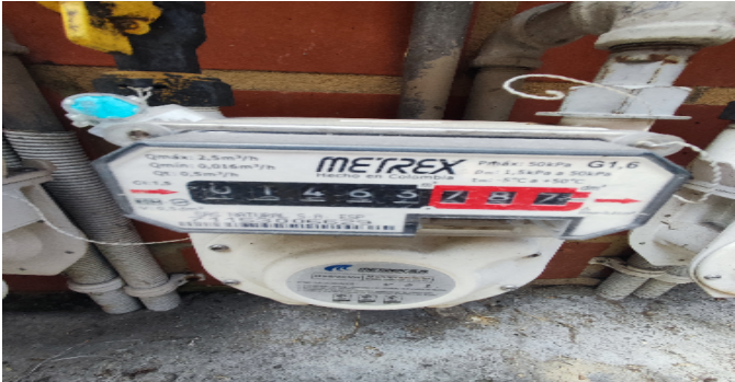
Contador de Gas
