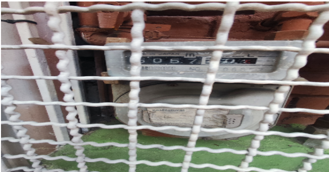
Contador de Gas
