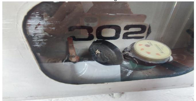
Contador de Agua
