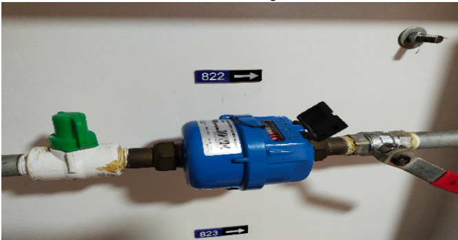
Contador de Agua
