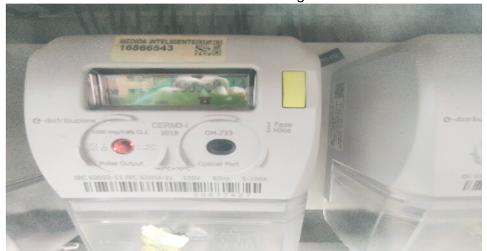
Contador de Energia
