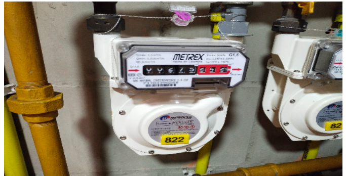
Contador de Gas
